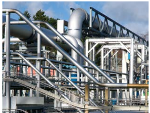
Ystad kommuns reningverk Sjöhög är numera självförsörjande på tekniskt vatten genom att rena det utgående avloppsvattnet från mikroorganismer.
