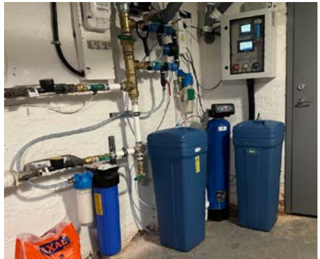
Anolytech-installationen i fastighetens källare i anslutning till point-of-entry tar liten plats och är ljudlös.
